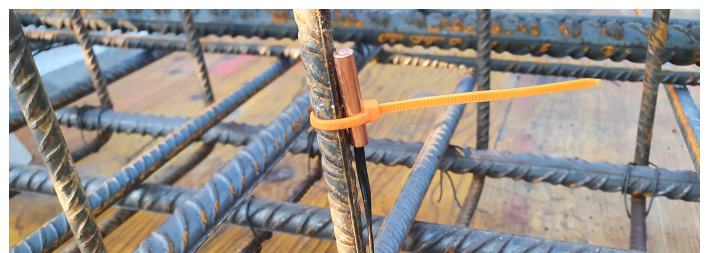
Sensor de madurez Cosmos instalado en la armadura de un forjado.
